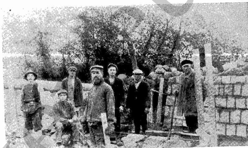
Рис. 16. Артель причудских каменщиков на строительстве «скотника»; подрядчик из Калласте. Конец 1920-х гг.
